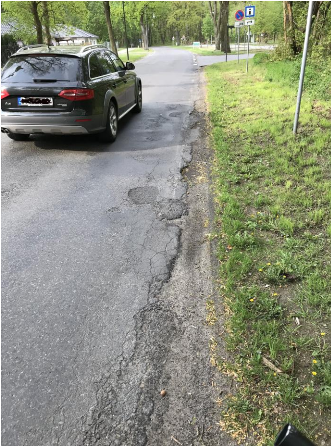
Abb. 10: Straßenschäden: Silberberger Straße in Höhe Parkplatz 'Stro- lin' in südlicher Fahrtrichtung
