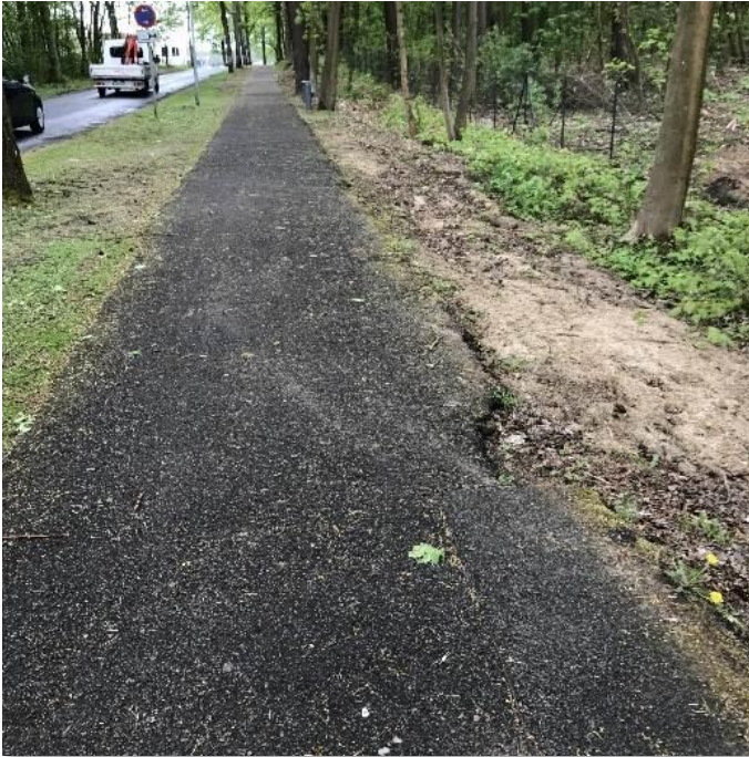
Abb. 34: Sanierungsbedarf bei Rad- und Gehwegen: Beispiel kombinierter Geh- und Radweg im Zuge der Pieskower Straße (westliche Straßenseite) in südlicher Blickrichtung
